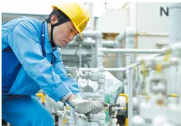
佐藤さんに、水素混焼試験時の様子を再現してもらいました。ほかのメンバーが現場で確認する計器の数値や、中央制御室からの指示のもと、手でバルブの開閉を行ったそうです。
